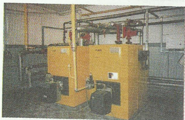
Kotłownia w Sz.P.Chojno
